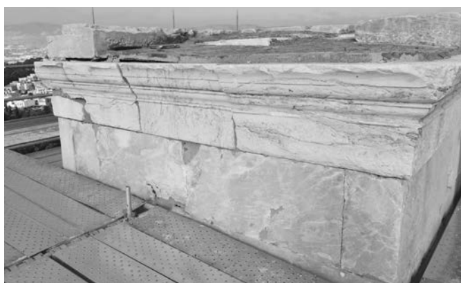
Άποψη από ΝΑ της ανωδομής του μνημείου πριν τις εργασίες συντήρησης. Φωτ. Κ. Φραντζικινάκη, 2022
