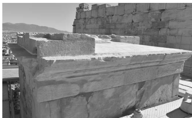
Άποψη από Ν της ανωδομής του μνημείου μετά τις εργασίες συντήρησης και την αποκατάσταση της στεγάνωσης της επίστεψης. Φωτ. Κ. Φραντζικινάκη, 2022
